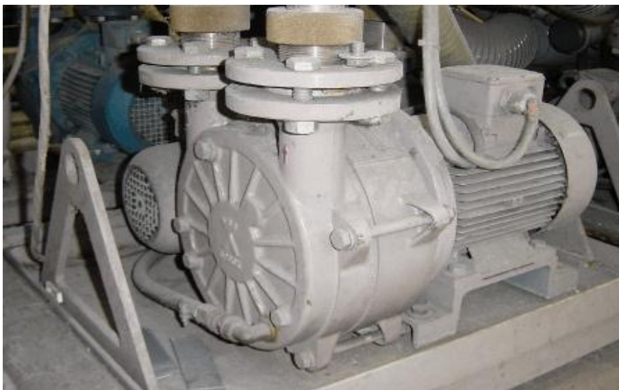
Abb.4: Pumpeneinheit bestehend aus 1-stufige Vakuumpumpen und Wasseraustragspumpe
